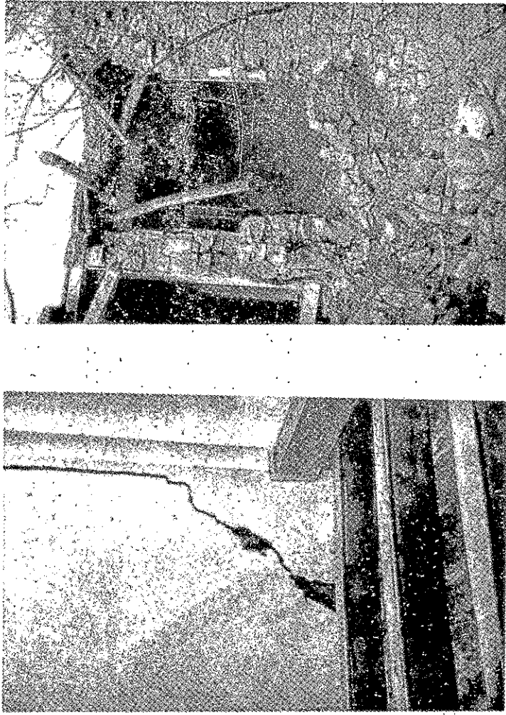
Рис. 1. Типичные повреждения строений в с. Кизлярь.
