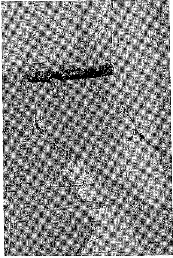
Рис. 7. Отход отмытки деревянно-щитового здания в результате разжижения песчано-глинистого грунта
