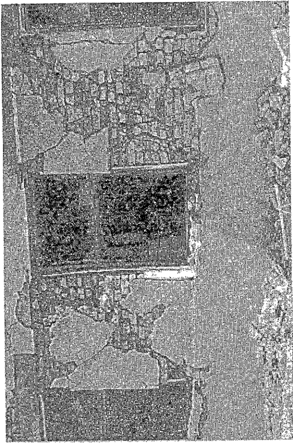
Рис. 6. Разрушение перемычек с расслоением кирпичной кладки детского сада "Гуляч"
