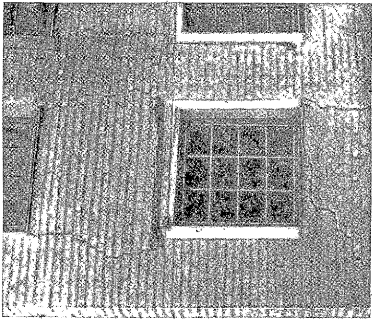
Рис. 2. Двухэтажное здание из жженого кирпича. Расслоенный кладок
